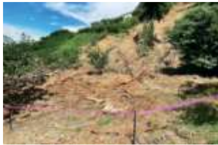
柿園内へ土石流入
